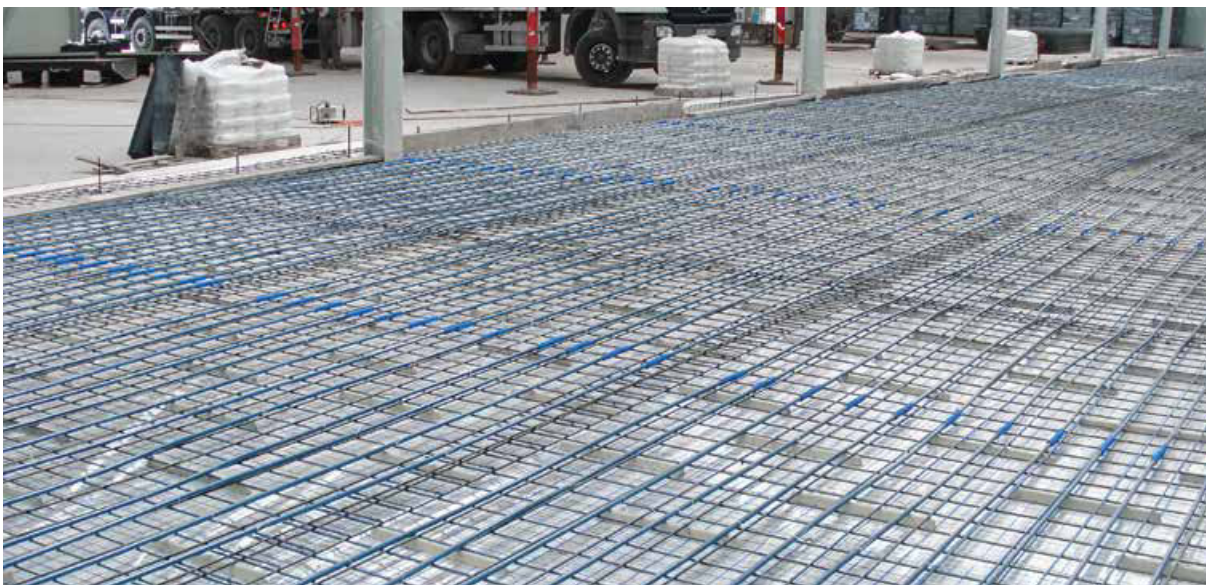
Joon. 4. Tööstushoone põrandaküttepaigaldis, milles kasutatakse bluePERT torusid ja süsteemi KAN-therm NET.
